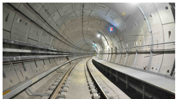
SafetySign SOS monterad i M4 Cityringentunneln.
