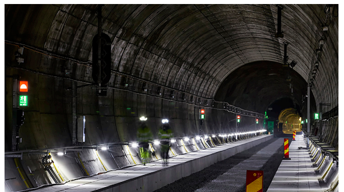
Safety Line LED monterad i Hallandsåstunneln.
